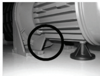
Contr ler r guli rement l' tanch it ! (Une fuite au niveau de la garniture m canique peut provoquer des dommages importants!)
