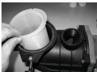
Nettoyage quotidien du panier de pr filtre.
